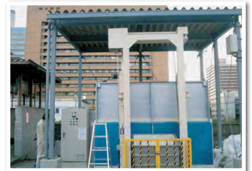
東京築地卸売市場の分解消滅型生ごみ処理機。微生物が有機物を分解します
